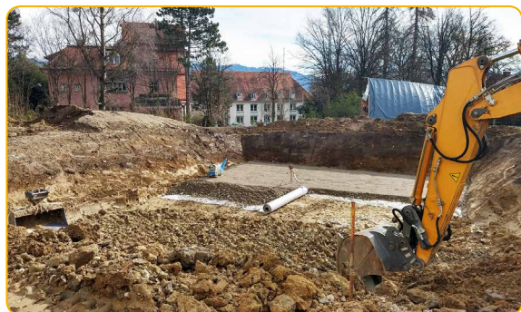
Dieses Loch ist nur für den Keller. Das Erdgeschoss ragt weit darüber hinaus.
